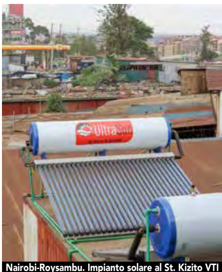
Nairobi-Roysambu. Impianto solare al St. Kizito VTI
